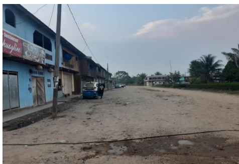
F24: Vía principal de acceso sin pavimentar.
